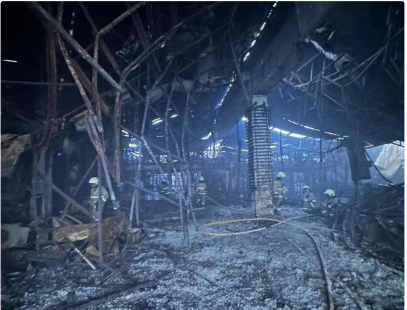
Glodok Plaza yang Hangus Terbakar
